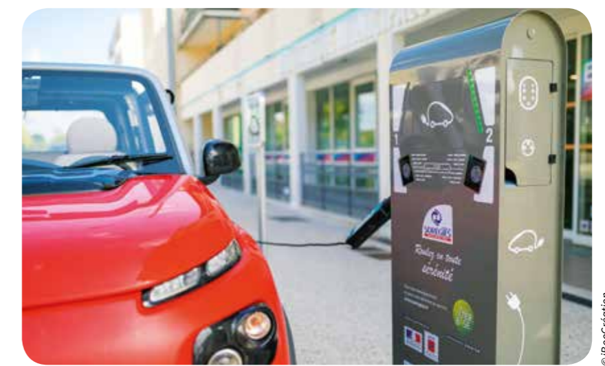
Bornes de recharges électriques à Buxerolles
